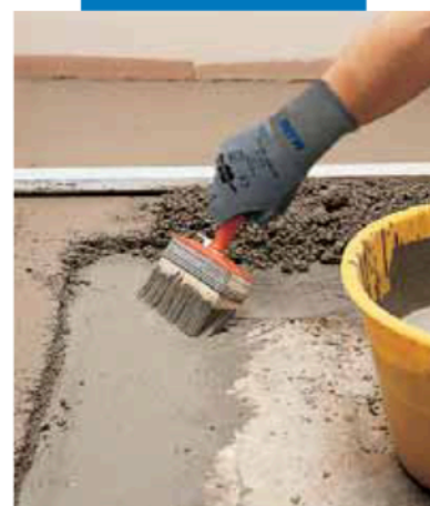
Aplicación de la lechada de adherencia para recrecidos adheridos realizados con Mapecem
